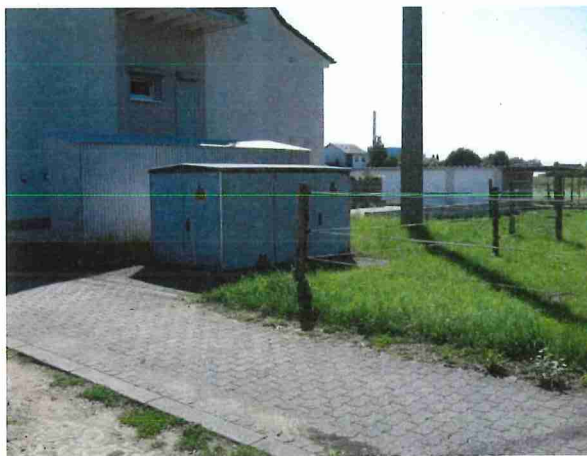
Foto 7: Trafostation an der Holzmühler Straße
